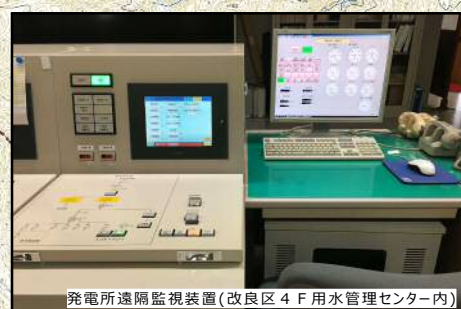
発電所運転制御盤
